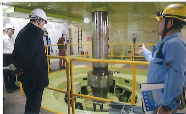
▲発電中であれば、毎分333回転する水車。回転数は水量に関係なく常に一定になるよう制御されています。水車軸の直径は50センチあります
